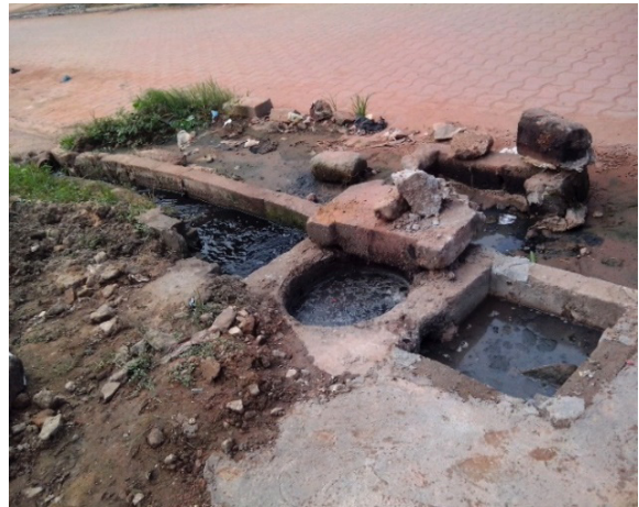
Photo 1 : Réseau d'assainissement saturé au quartier Poro 1 (Cliché Michel T., 2014)
